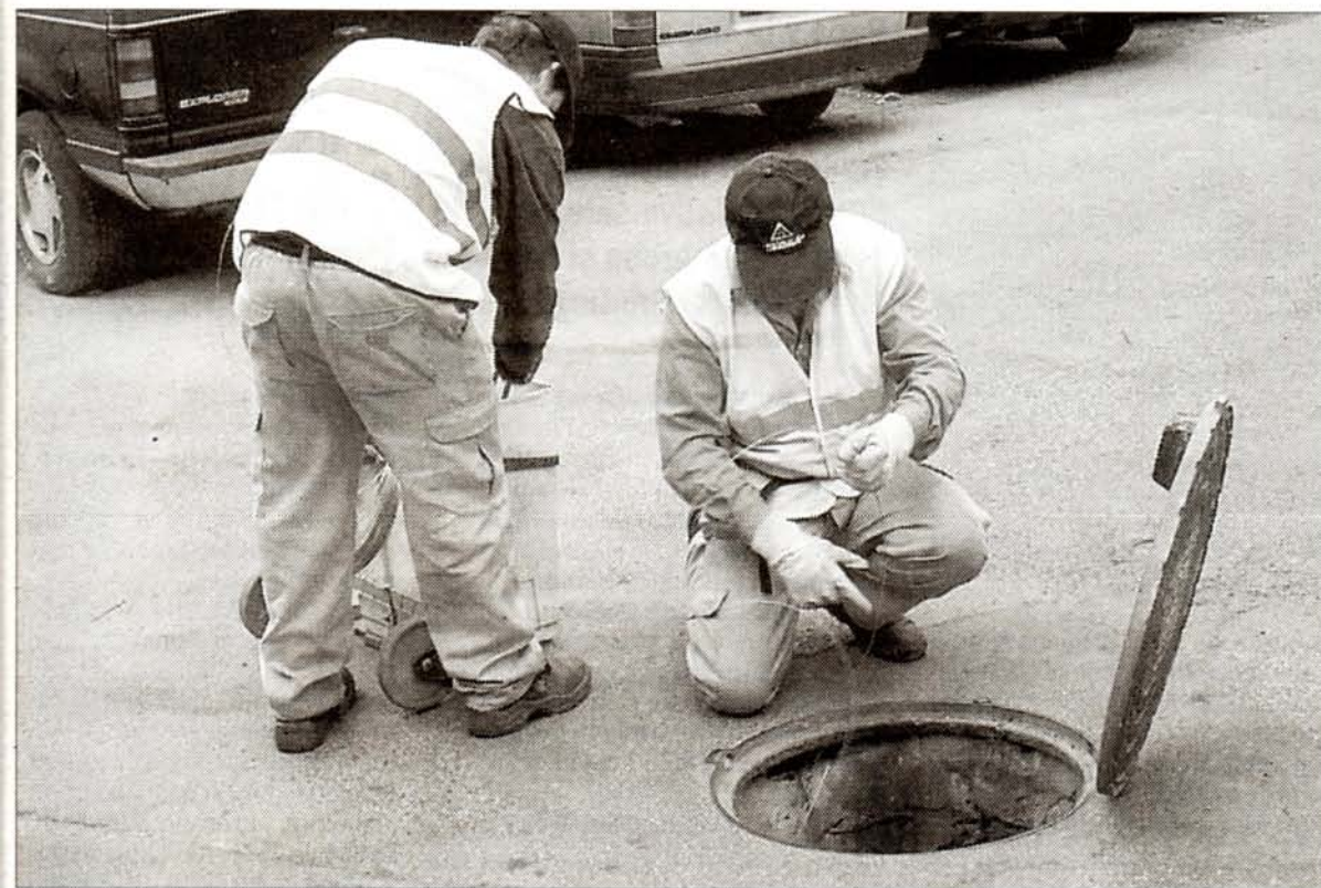
Dos técnicos inspeccionan una trapa de alcantarilla, dentro de la campaña de fumigación de la Concejalía de Sanidad. /LP
